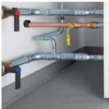
Conexión de caldera: salida y entrada con Prestabo y válvulas Easytop. Conexión para gas con Profipress G.
